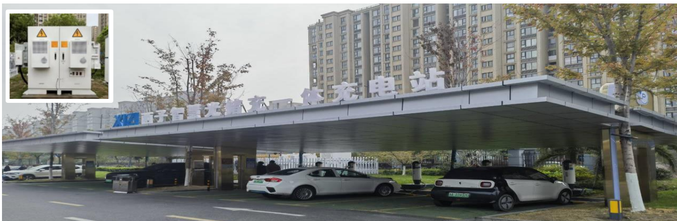
Dự án Lưu trữ năng lượng thông minh tại Chiết Giang, Trung Quốc Quy mô hệ thống: 100kW/200kWh
