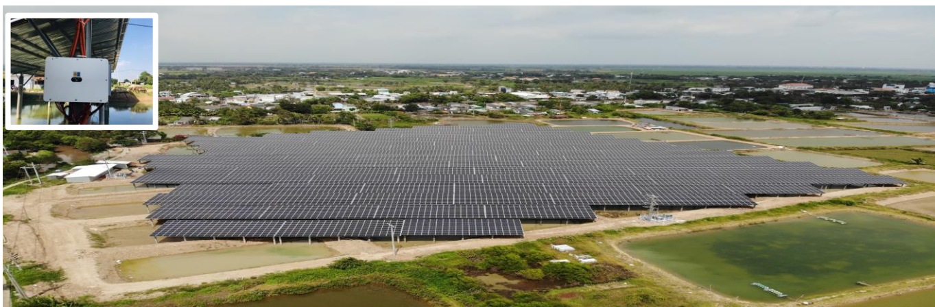
Dự án Điện Mặt Trời áp mái Công Nghiệp tại tỉnh Bình Phước, Việt Nam Quy mô hệ thống: 6MW
